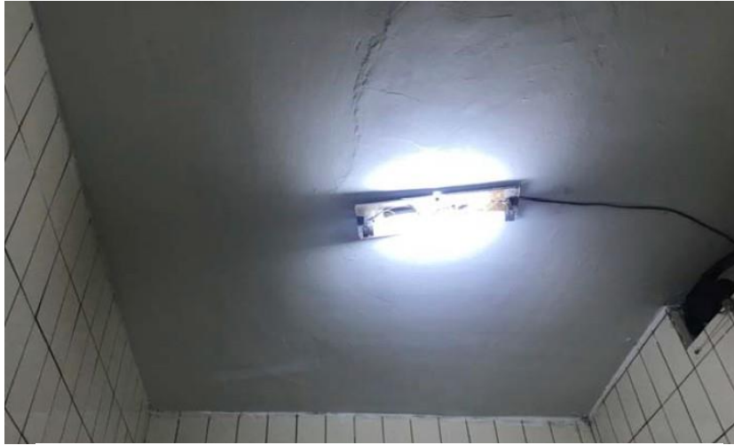
(說明: 平頂粉刷層拱起龜裂)
