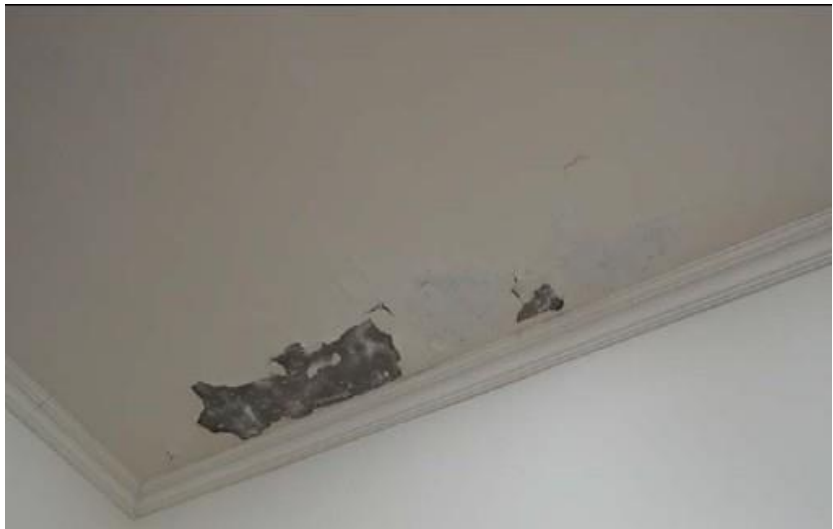
(說明: 平頂粉刷層拱起龜裂)
