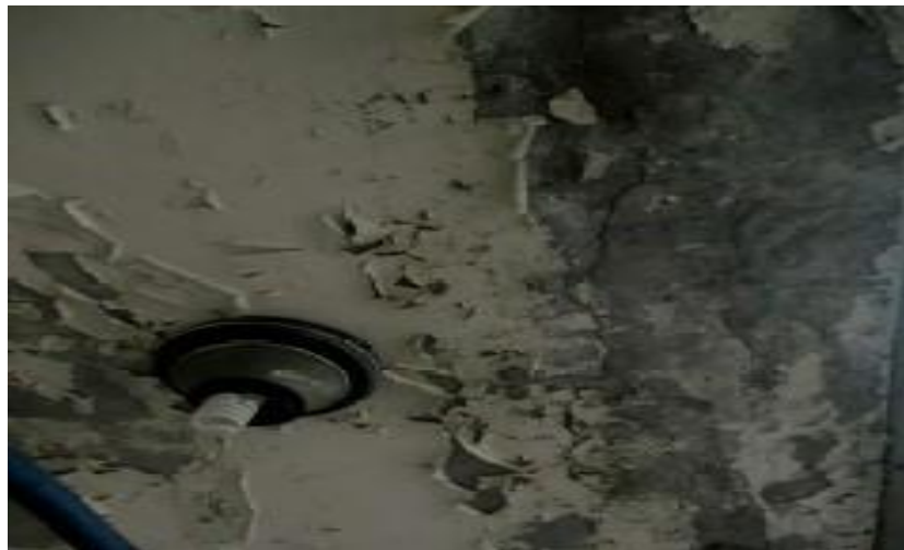
(說明: 平頂粉刷層拱起龜裂、剝落)
