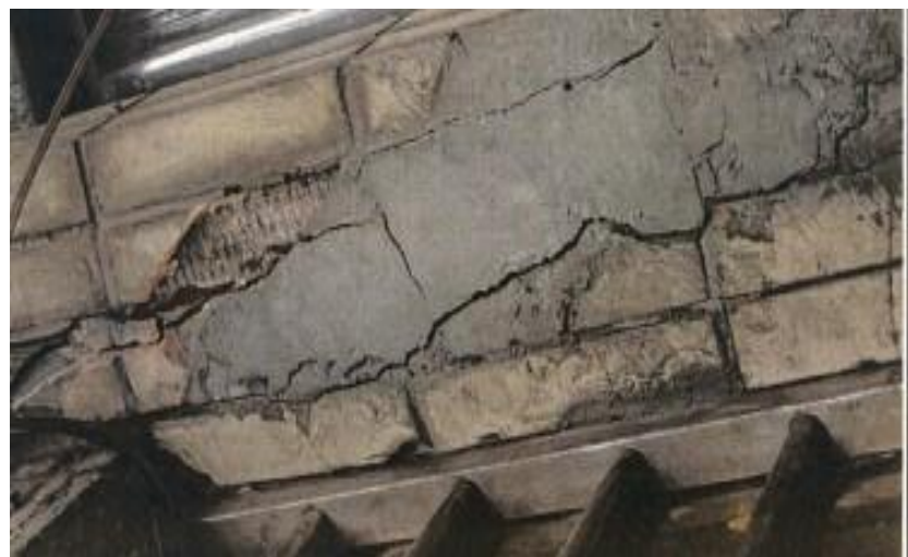
(說明: 樑保護層剝落及鋼筋外露)
