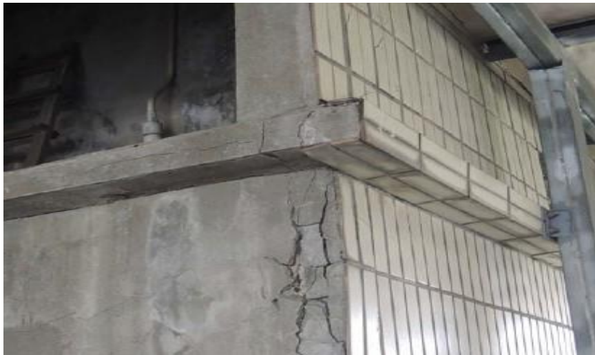
(說明:保護層剝落及鋼筋外露)
