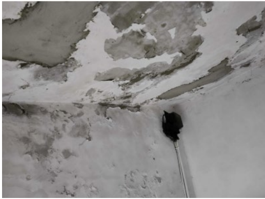
圖 10 建築物現況照片 (3) 莒光路 133 巷 8、10 號 滲水狀況
