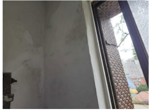
圖 9 建築物現況照片 (2) 莒光路 133 巷 8-5 號 裂縫狀況
