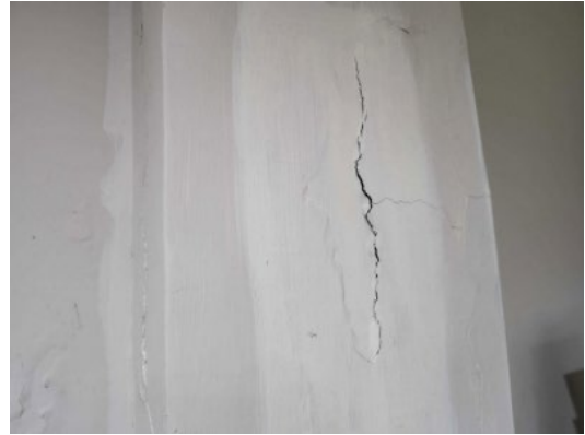
圖 15 建築物現況照片 (8) 莒光路 133 巷 28、30 號 柱裂縫現況
