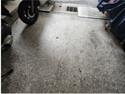
圖 14 建築物現況照片 (7) 莒光路 133 巷 24、26 號 地面裂縫
