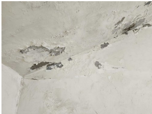
圖 16 建築物現況照片 (9) 莒光路 133 巷 36、38 號 滲水狀況
