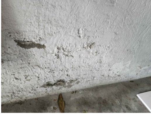
圖 8 建築物現況照片 (1) 莒光路 133 巷 8-1、8-3 號 滲水狀況
