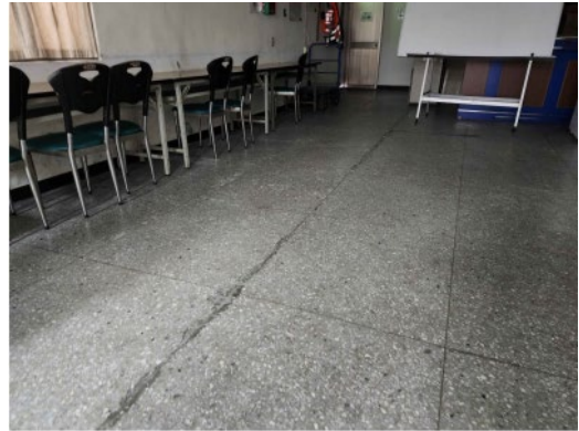
圖 17 建築物現況照片 (10) 莒光路 133 巷 40、42 號 地板裂縫及傾斜
