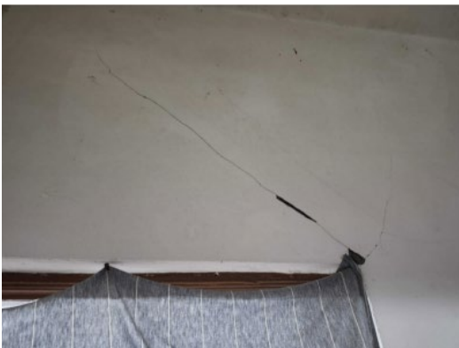
圖 12 建築物現況照片 (5) 莒光路 133 巷 16、18 號 裂縫狀況
