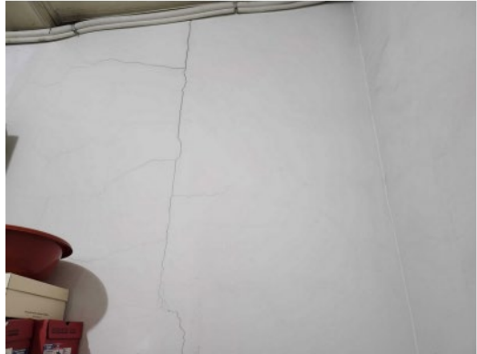
圖 11 建築物現況照片 (4) 莒光路 133 巷 12、14 號 裂縫狀況
